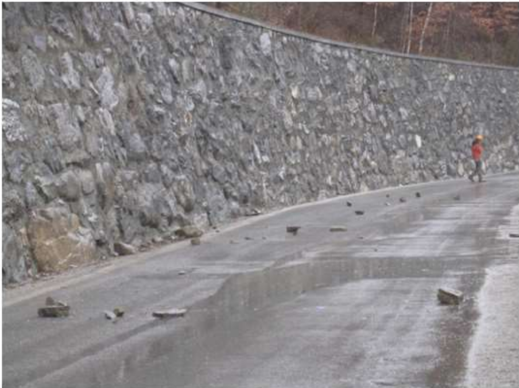
Elementi lapidei disgiunti lungo la zona di scorrimento e caduti sulla strada.
